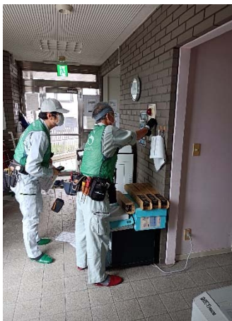
火災報知器点検
